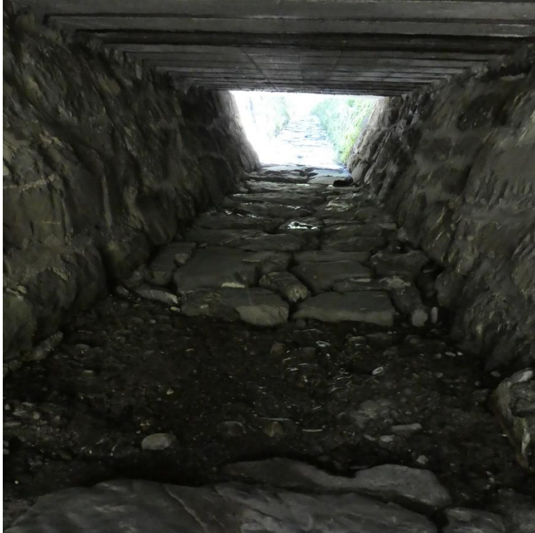
Foto Nr. 12: Lokale Schadstelle in der Sohle mitten im Durchlass
