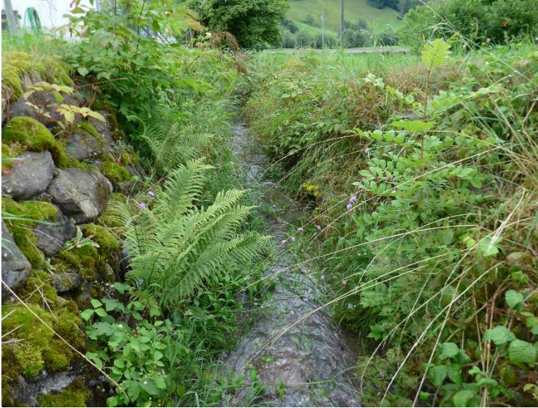
Foto Nr. 10: Schwachstelle im Wühr unterwasserseitig des Durchlasses
