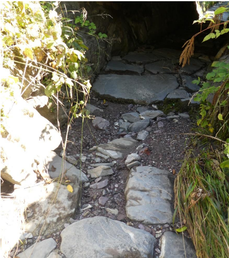
Foto Nr. 11: Lokale Schadstelle in der Sohle unterwasserseitig des Durchlasses
