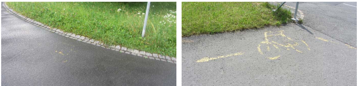
Abbildung 12: Schlecht erkennbare Bodenmarkierung (links in Niederurnen, rechts in Linthal)
