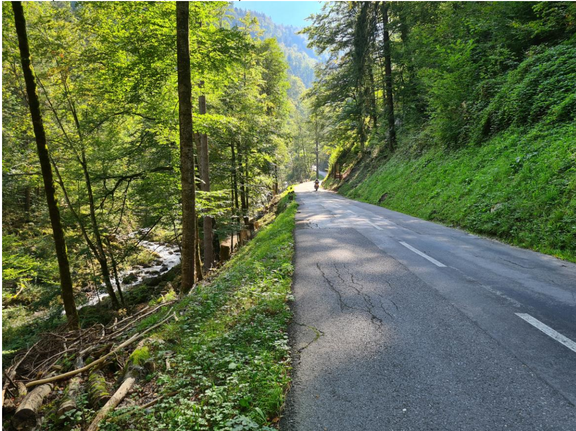
Abb. 4: Instabiler Fahrbahnrand und fehlendes talseitiges Bankett Die abgedrückten Strassenränder wurden wiederholt mit Belag saniert. (Foto: M. Ammann, 15.09.2020)
