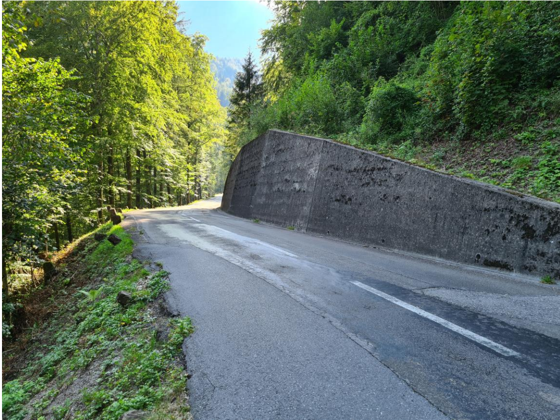
Abb. 3: Abgedrückte talseitige Strassenränder und schiefstehende Wegsteine Im Bereich der Stützmauer beim Projektanfang fehlt ein talseitiges Bankett (Foto: M. Ammann, 15.09.2020).
